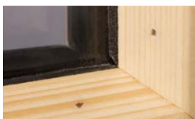
Herkömmlich befestigte Glasleiste mit sichtbaren Nägeln.
