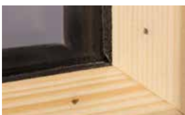
Herkömmlich befestigte Glasleiste mit sichtbaren Nägeln.
