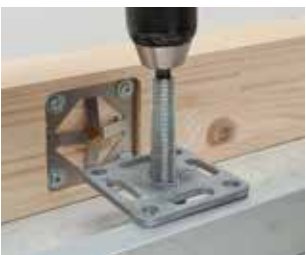
Fixation de la tige filetée dans le béton et si un réglage est souhaité, vissage de la ferrure WALCO® 80 M16 soudé.
